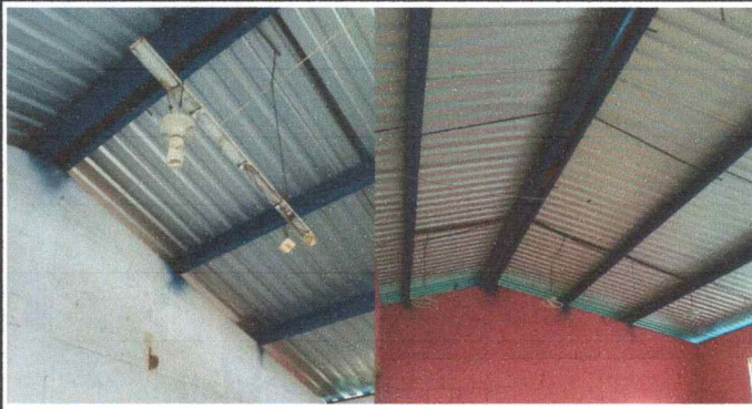
Foto1: se obserba que las aulas no poseen energia electrica
