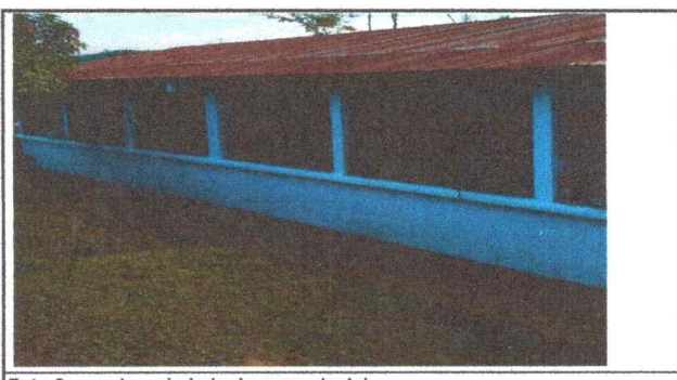
Foto 6: canales y bajada de agua pluvial
