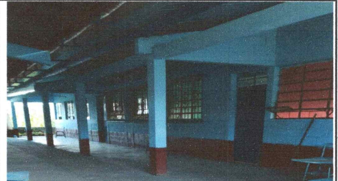
Foto 2: imagen de las aulas las cuales se les hara instalacion electrica por dentro y por fuera.
